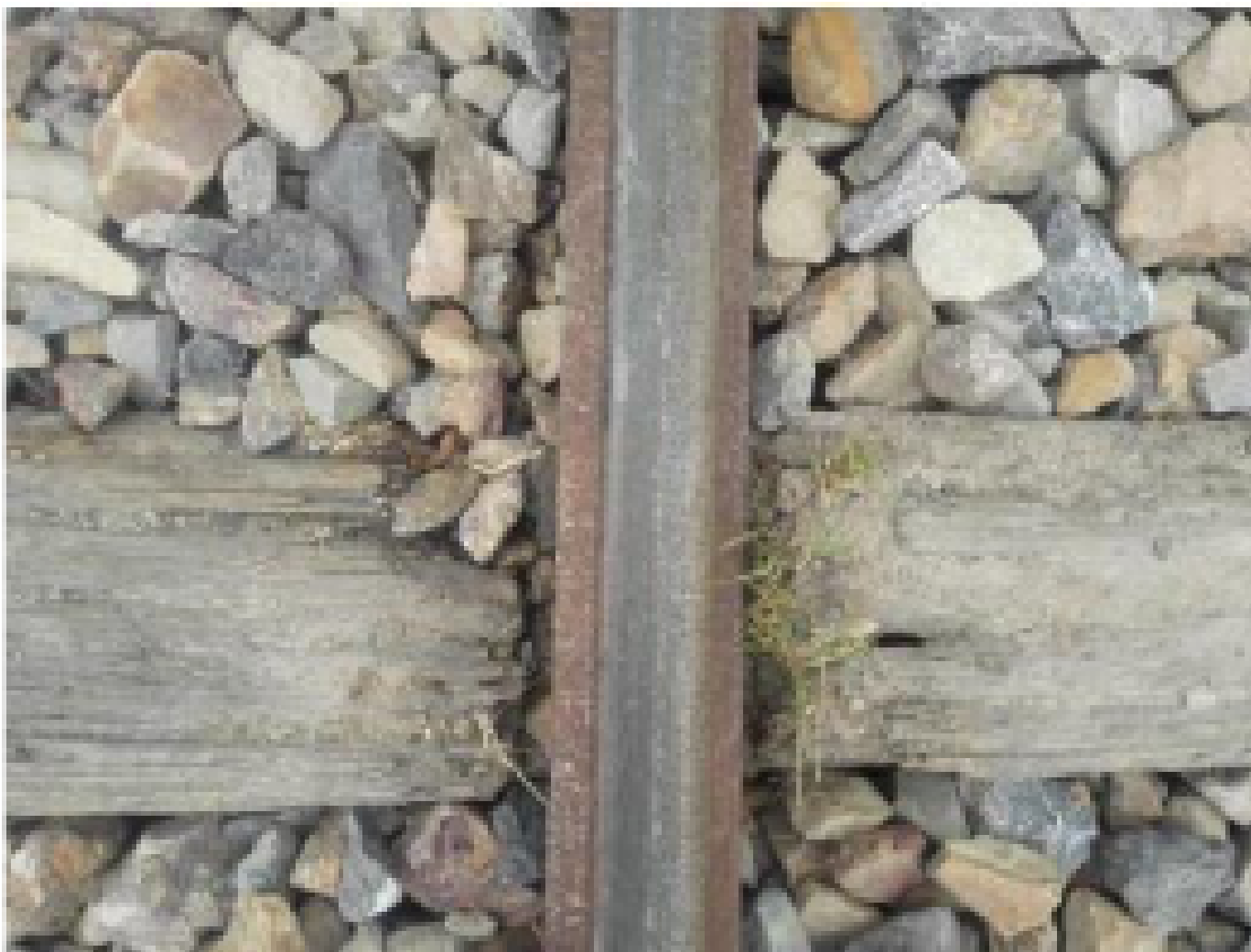
Figura 17 Rompimiento de madera
