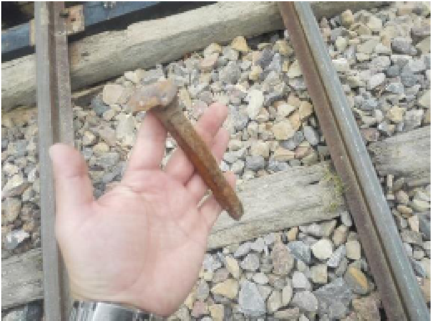
Figura 16 Defecto de no fijación en el durmiente
