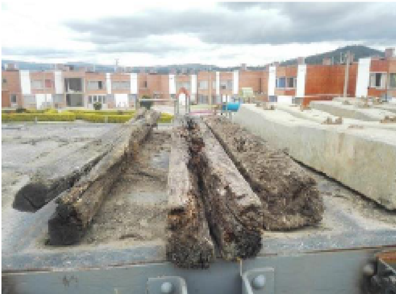
Figura 14 Pudrición del durmiente de madera
